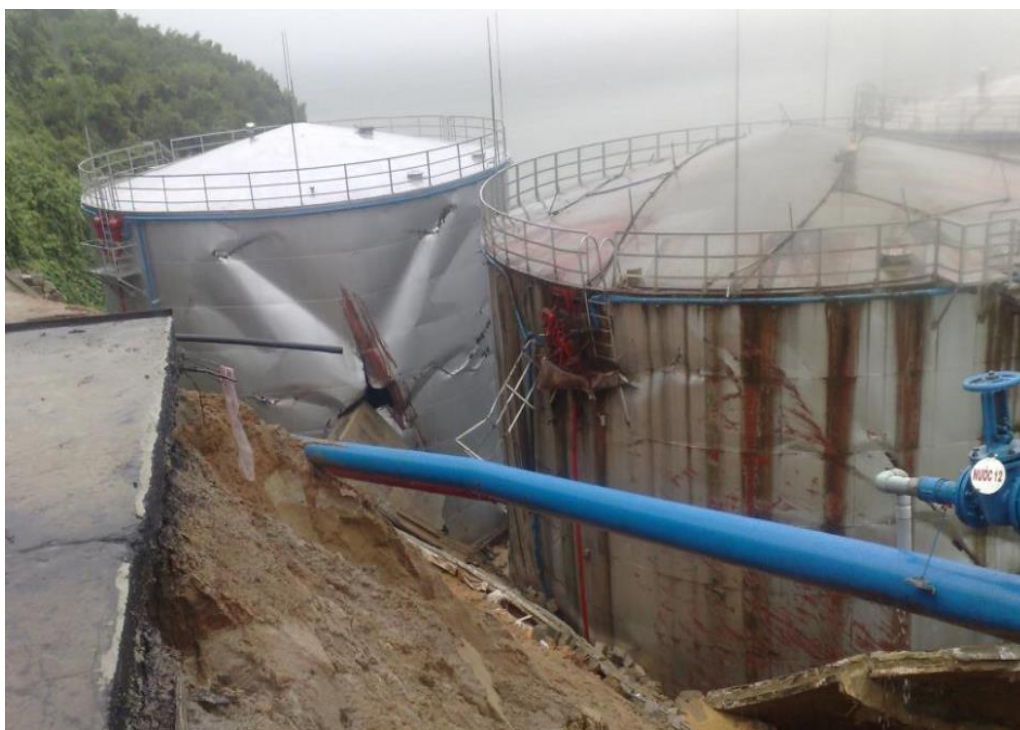
Рис. 2. Общий вид резервуаров после ликвидации аварии на нефтебазе «Льен Чиеу»
